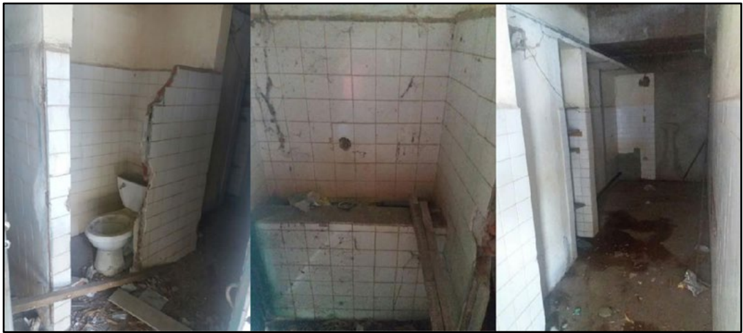
Figura 7. Estado de Baterías Sanitarias
