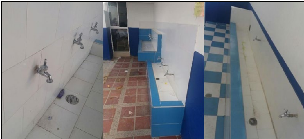
Figura 6. Estado de la grifería
