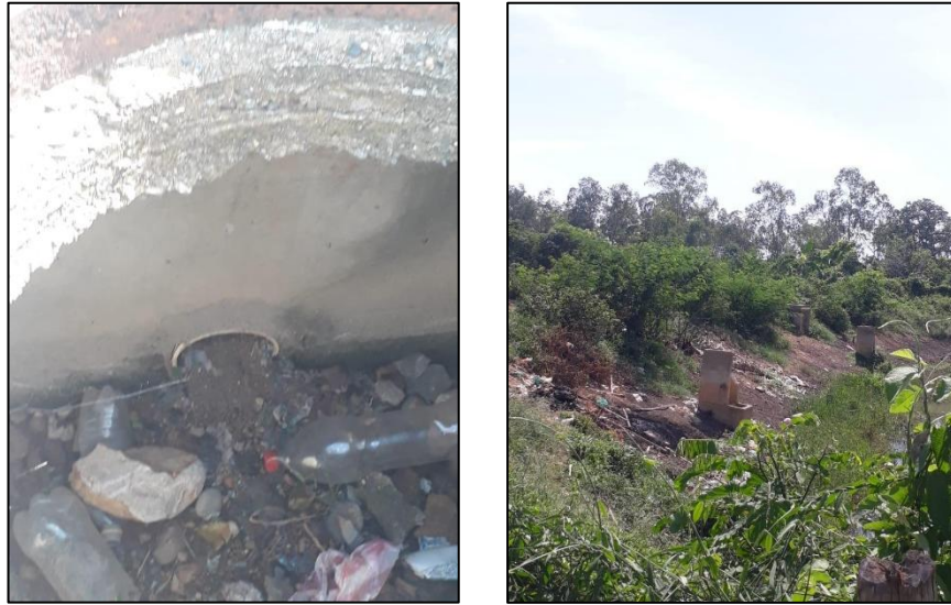
Fotografía 6. Estado del emisario final y de la corona de la laguna Fuente: Autoras, 2019
