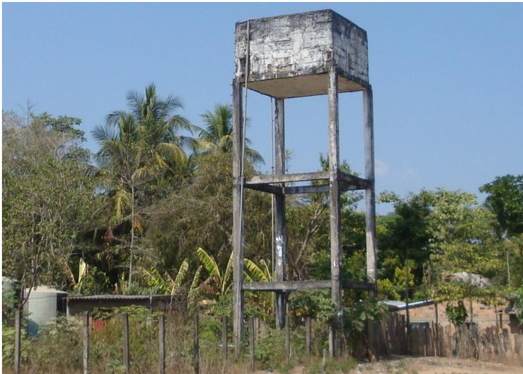
Foto 20. Tanque de almacenamiento elevado acueducto de San Sebastián
