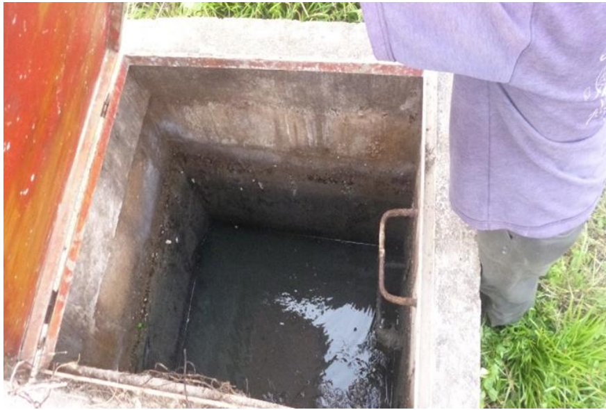
Foto 11. Pozo de Llegada y succión aguas residuales sistema de bombeo de Puerto Boca
