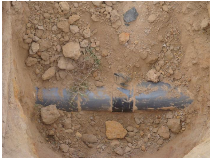
Foto 21. Tubería de 3" pulgadas de diámetro, red de distribución San Sebastián
