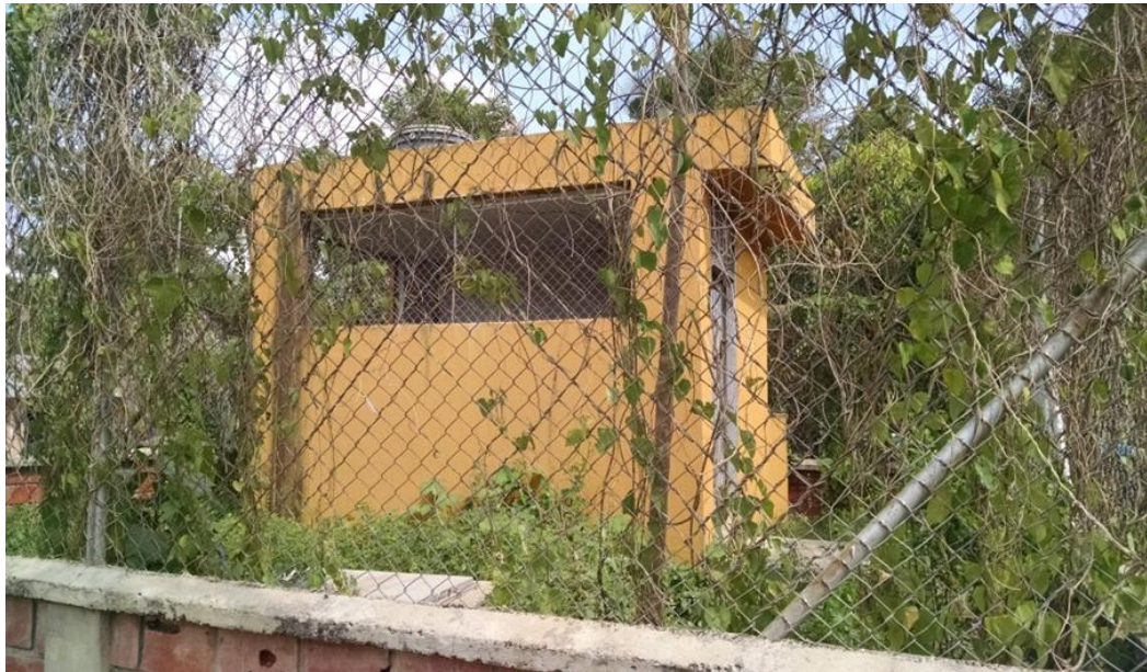
Foto 10. Estación de bombeo del sistema de alcantarillado Puerto Boca
