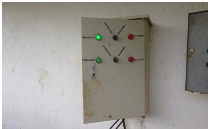
Foto 13. . Tablero de control sistema de bombeo Puerto Boca
