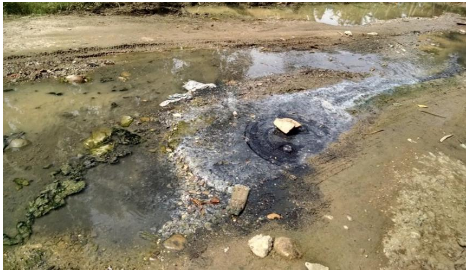
Foto 16. Pozo de inspección en mal estado en Puerto Boca (Coordenadas X: 1027108 Y: 1471207 altura: 29m)
