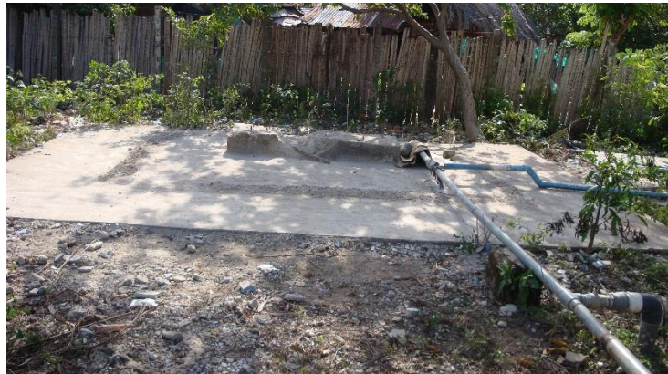
Foto 18. Sistema de bombeo pozo profundo Acueducto de San Sebastián
