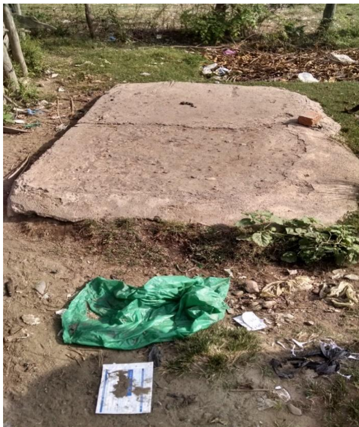
Foto 7. Poza séptica en mortero en donde se depositan las aguas residuales de los hogares del corregimiento de La Mata
