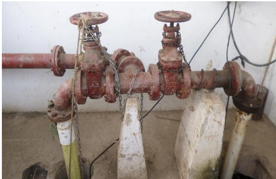
Foto 12. Válvulas de control salida aguas residuales Sistema de Bombeo Puerto Boca
