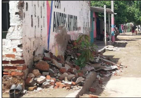
Fotografía 2 Residuos de Demolición y Construcción
