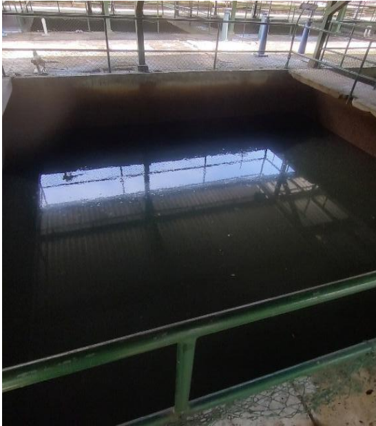
Figura 18. Lavado de filtros
